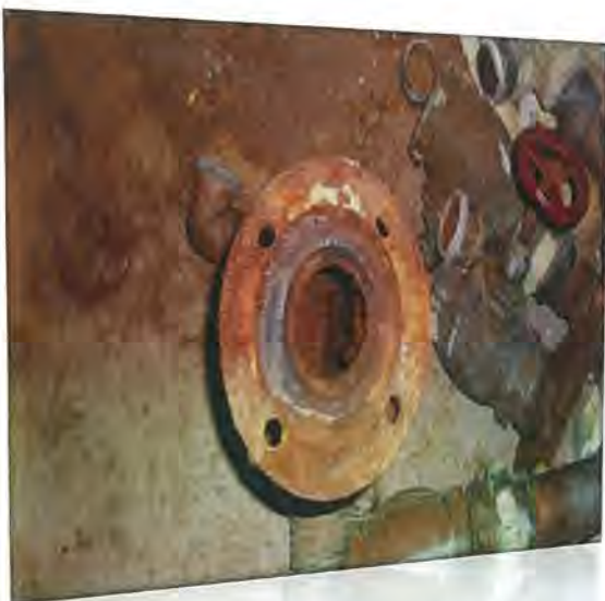
Gjengrodde ventiler til dusjanlegget
