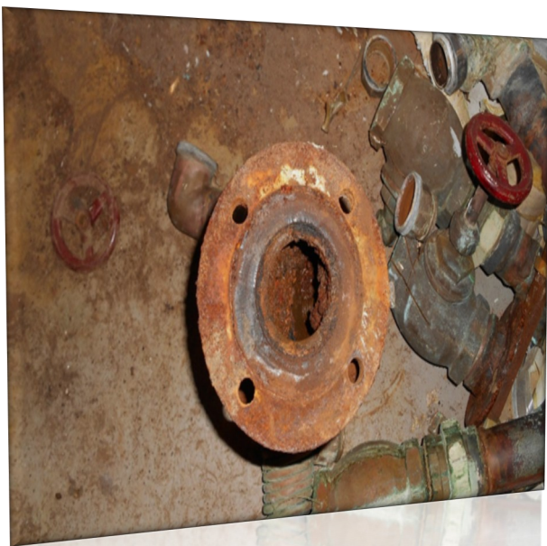
Gjengrodde ventiler til dusjanlegget
