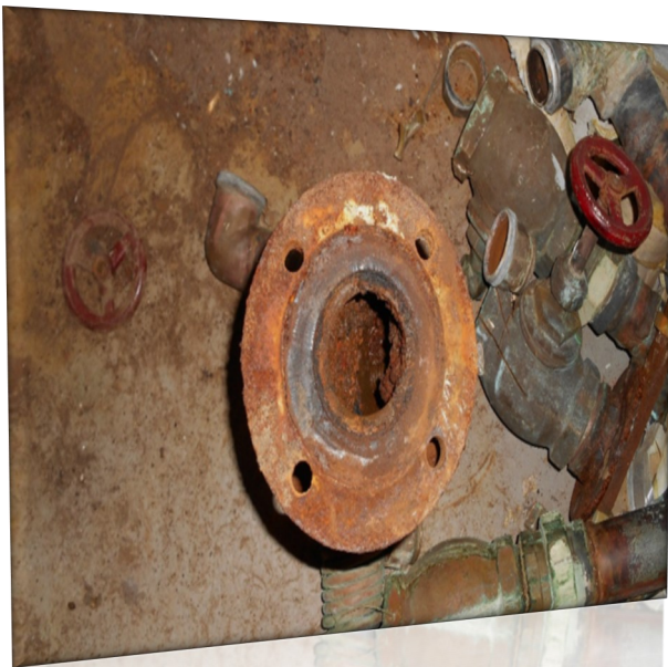
Gjengrodde ventiler til dusjanlegget
